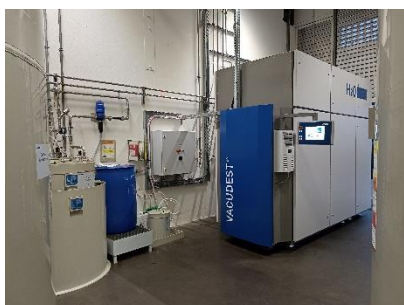
L'évaporateur permet de traiter 1000 m 3 d'eau usée par an.
